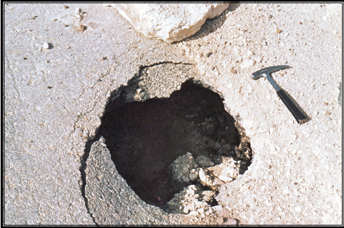
الصورة (2) الحفر الكارستية (Sink hole) على الطريق العام (سماوة - سلمان) التقطت بتاريخ 2004/5/23
